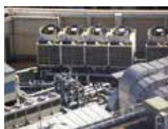
屋上・屋外空調機
