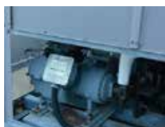
ガスジェネレーター・発電機
