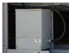
変圧器・変流器
